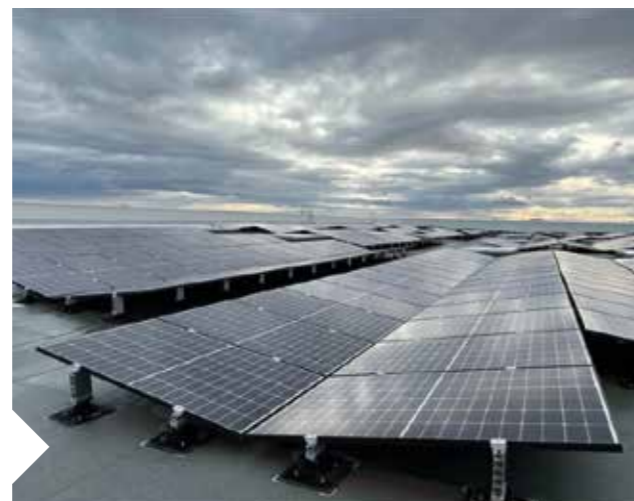
Centrale photovoltaïque sur le projet Maison de couture
