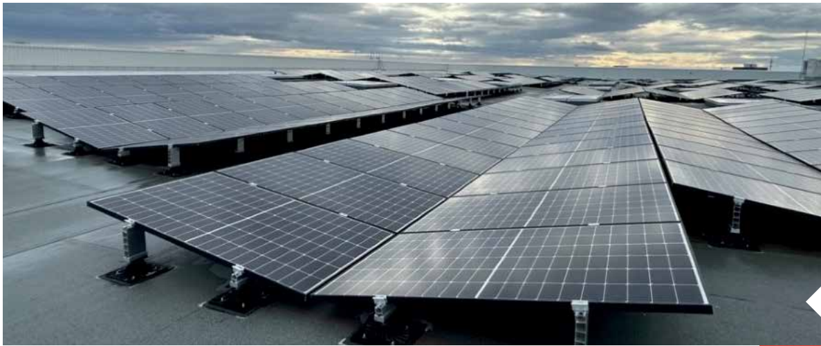
Mise en service d'une centrale photovoltaïque par IDEC ENERGY sur le projet de Maison de couture à Blois (41)
