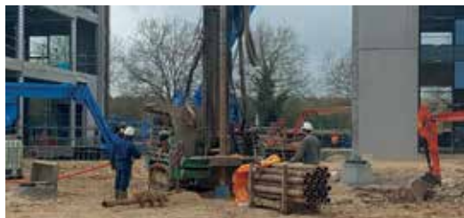
CENTRALE DE GÉOTHERMIE
